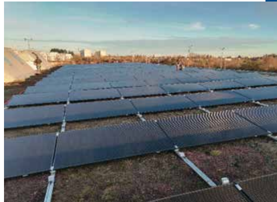
PV-Installation auf der Sporthalle, Neuried, November 2024
