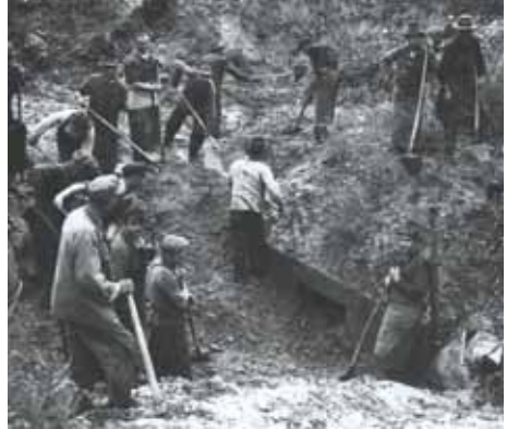
Arbeiter schaufeln die verschüttete Pumpe in der Neurieder Kies- und Müllgrube frei.
