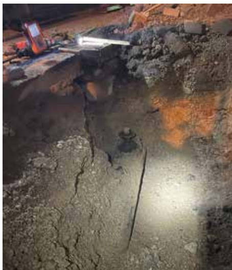
Die reparierte Schadensstelle der Gashauptleitung (FF Planegg)
